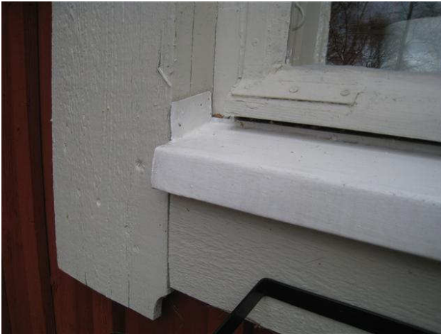
Kuva 39 Ikkunan vesipellityksessä on rakoja.
