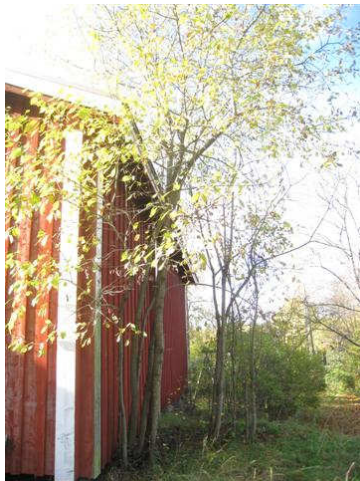
Kuva 51 Pohjoissivun vieressä on puu, rännit puuttuvat räystäältä.
