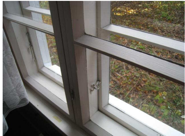
Kuva 42 Ikkunoissa on käyntivälivikoja ja kaarevuutta puitteissa.
