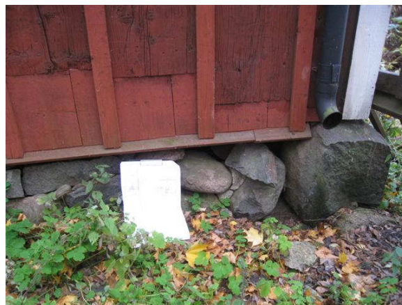
Kuva 6 Lautojen jatkoksia, heikko sokkelilista, sokkelikiviä irti.
