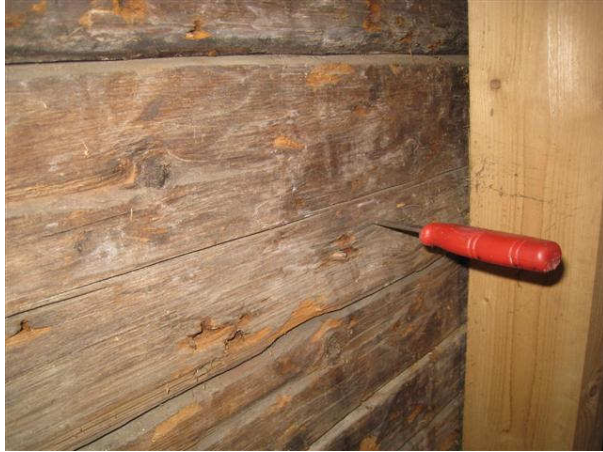
Kuva 67 Osin lahoa hirttä navetassa.
