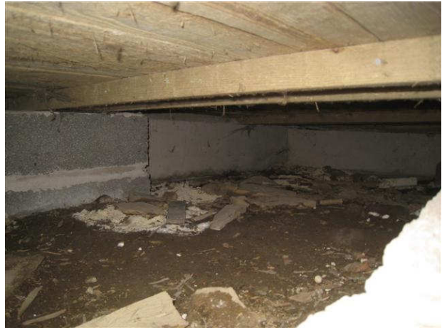
Kuva 10 Lounaiskulman mikrobivaurioitunutta pohjamaata.
