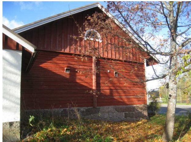
Kuva 62 Navetan itäpääty, jossa sokkelikivien saumassa on halkeilua.
