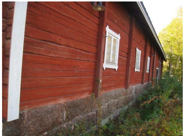
Kuva 60 Navetan pohjoissivua, alimmat hirret on uusittu. Kasvillisuus ja puuttuvat rännit lisäävät kosteuskuormitusta.
