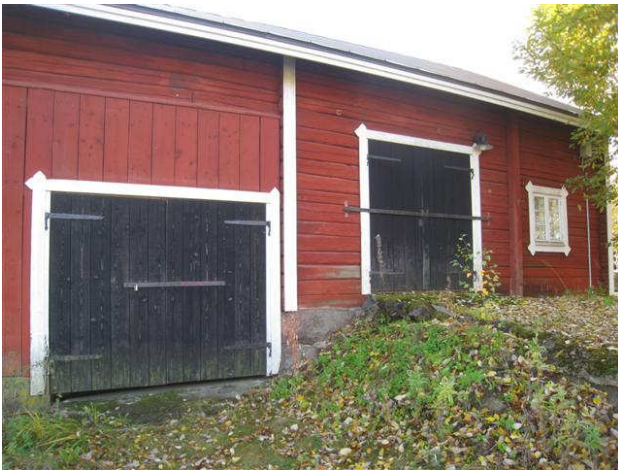
Kuva 63 Huonokuntoinen pohjoissivun luiska.
