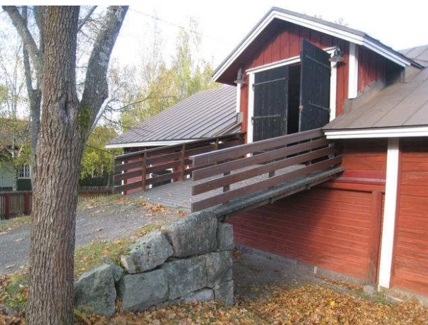
Kuva 65 Navetan ullakolle johtavan luiskan kaide on vajaa.
