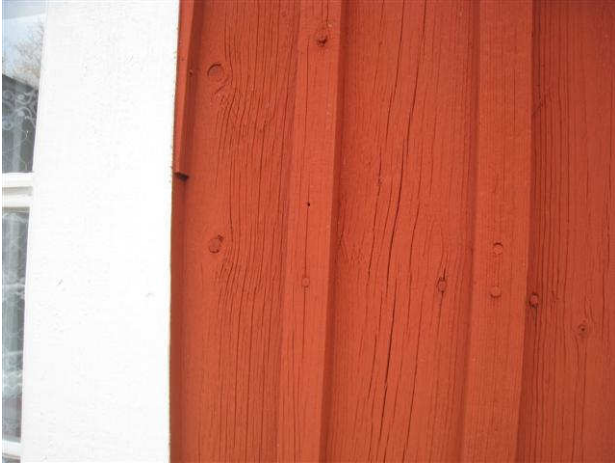
Kuva 37 Julkisivun halkeillutta laudoitusta.
