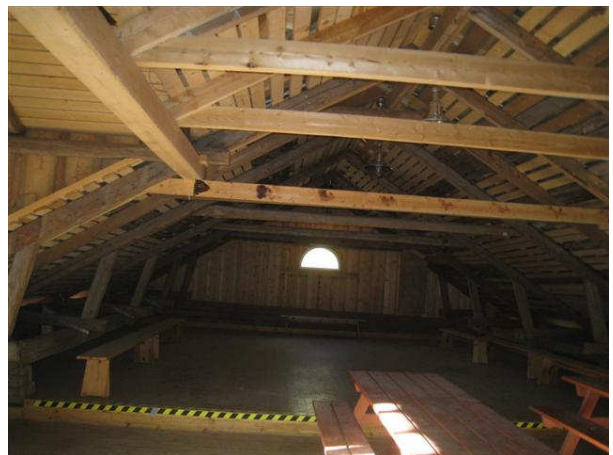
Kuva 72 Navetan ullakko ja kattorakenne, joka on voinut antaa myöten, koska on notkolla.
