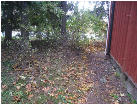
Kuva 3 Lounaiskulmalla pinta- ja kattovedet rasittavat perustuksia.
