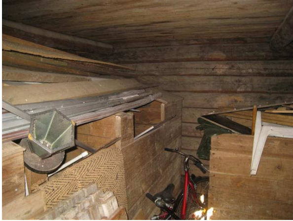
Kuva 55 Länsipäädyn vilja-aitan välipohja on vanha.
