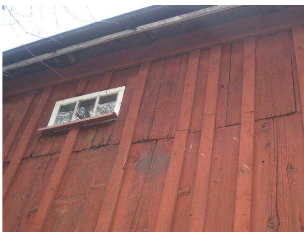
Kuva 15 Jatkettuja lautoja räystäään alla.
