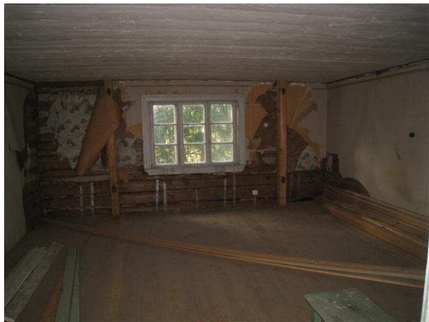
Kuva 22 Kesken jäänyt ullakkohuoneen korjaus.
