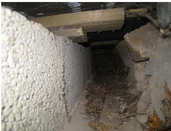
Kuva 35 Sokkelin takana oleva apumuuraus ja välinen ontelo. Alapohjan alpinta on bituliittia.
