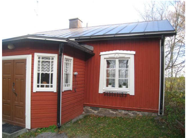
Kuva 32 Sokkelit ovat matalia, kattovesien poistoa ei ole sokkelin viereltä.
