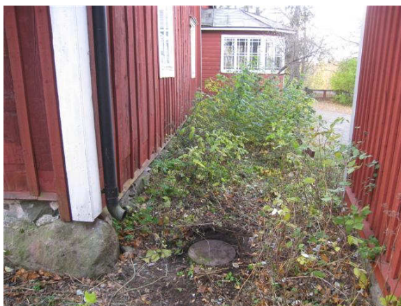
Kuva 5 Koilliskulman salaojakaivo päärakennuksen ja renkituvan välissä. Kasvillisuus rehottaa seinävierellä
